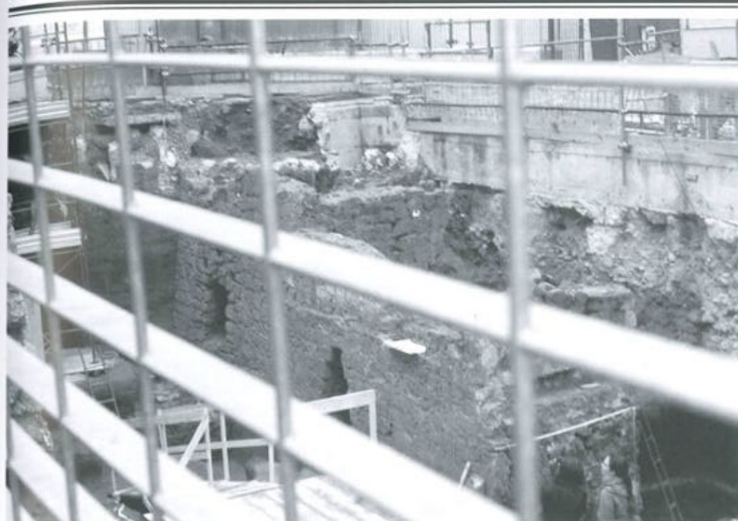
2/ Napoli. Lo scavo innanzi S. Maria delle Grazie a via Toledo, per la costruzione della Metropolitana, linea 1. È risultato visibile parte della cinta muraria aragonese occidentale (foto dell'a., 2007).
