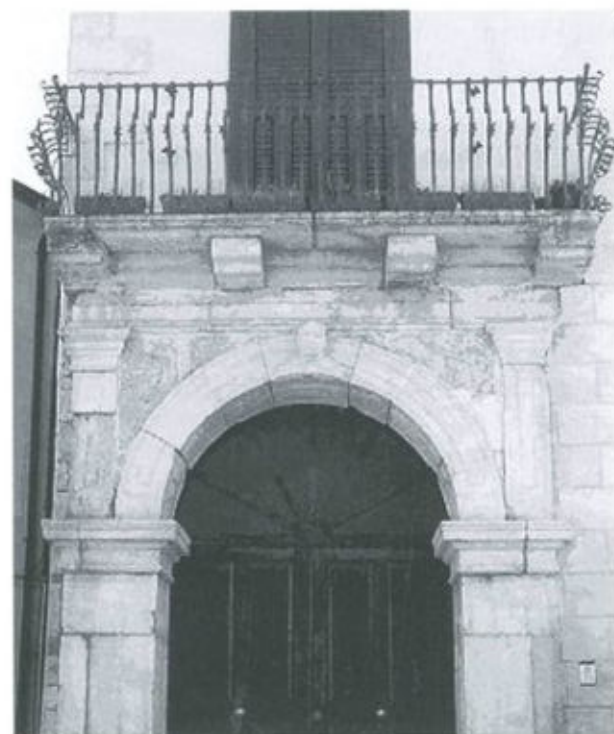
3/ Sant'Angelo dei Lombardi. Portale di casa Ricciardi. Foto a cura della Soprintendenza per i BAPPSAE di Salerno e Avellino, Istituto Comprensivo "V. Criscuoli", Sant'Angelo dei Lombardi, I PERCORSI DI "GENIUS LOCI", 2005.
