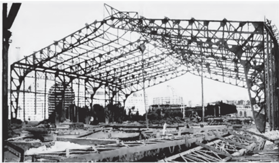
Fig. 8. Palazzo delle Belle Arti: le travi 'a ginocchio' della struttura portante, durante la costruzione. (da Frank Morton Todd, The Story of the Exposition ).
